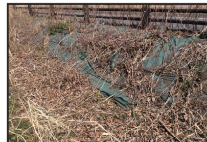
劣化した従来の 除草シートの現場
